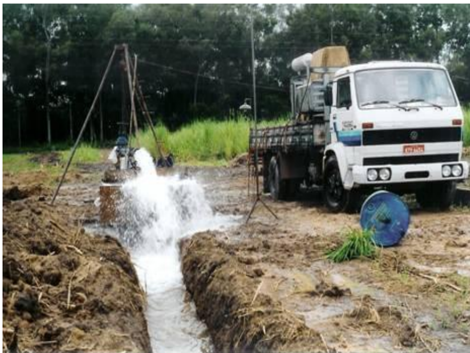
Foto 2- Bombeamento do Poço 2 da Usina de Queimado, na cidade de Campos, com vazão operacional de 180 m 3 /h. ( Foto E. Capucci)
